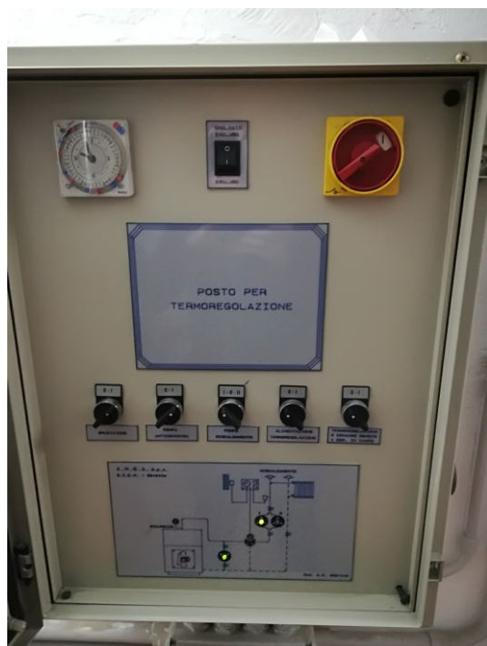
Figura 4.7 - Particolare del pannello di controllo di dell'impianto termico
