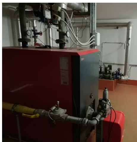
Figura 8.7 - Particolare del generatore di calore attuale
