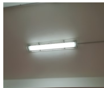
Figura 8.9 - Particolare di una lampada fluorescente attualmente installata
