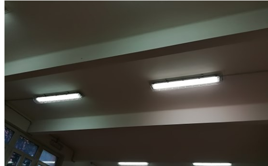
Figura 4.14 - Particolare dei corpi illuminanti ubicati nelle aule
