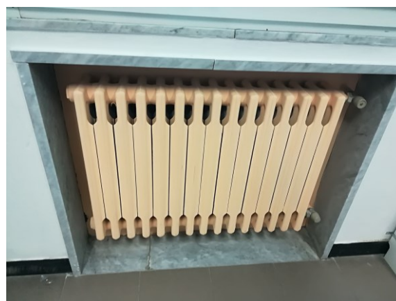
Figura 4.6 - Particolare dei radiatori installati sulle pareti esterne degli ambienti
