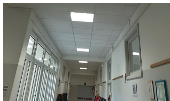
Figura 4.13 - Particolare dei corpi illuminanti ubicati nei corridoi
